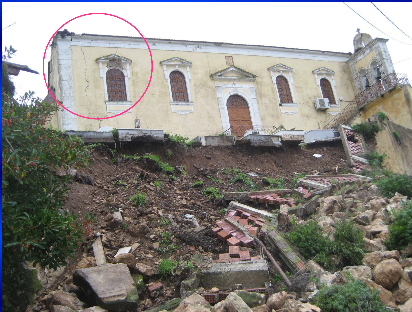
Ναός στη Βιλατόρια. Κατακόρυφες, κυρίως ρωγμές σε φέρουσες λιθοδομές. Το κωδωνοστάσιο κατέρρευσε στον δεύτερο σεισμό.
