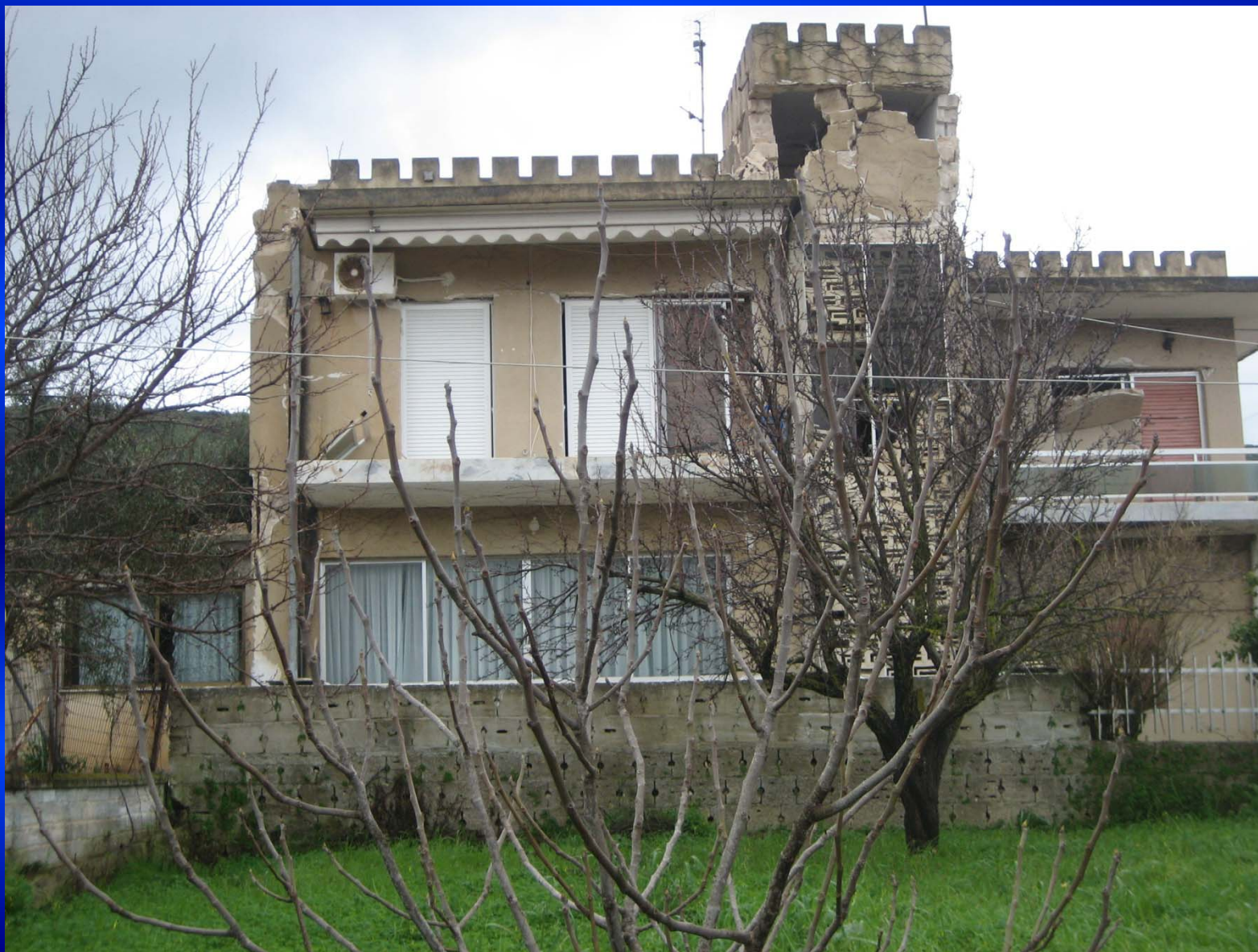
Κτίριο στο Λιβάδι. Αστοχίες σε δομικά στοιχεία από φέρουσα τοιχοποιία.
